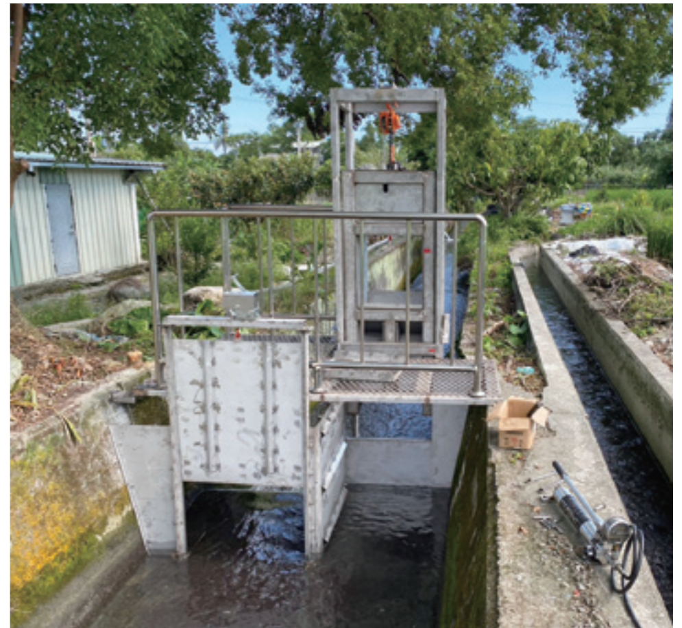
廣太綠能超低落差水力發電機組吉安圳示範場域
