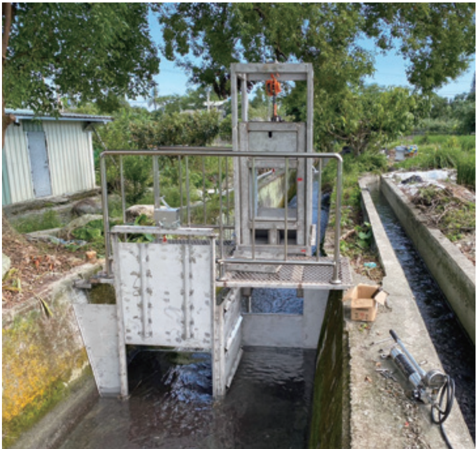
廣太綠能超低落差水力發電機組吉安圳示範場域
